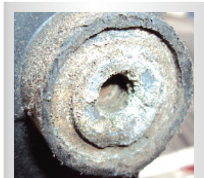
DAÑADA Por golpes o falso contacto en la conexión.
